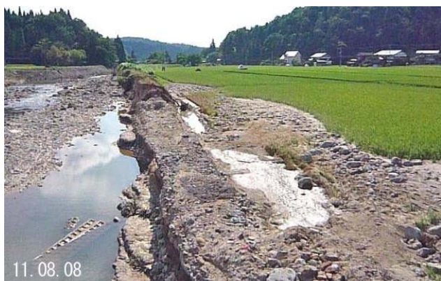
図5 破壊した堤防
