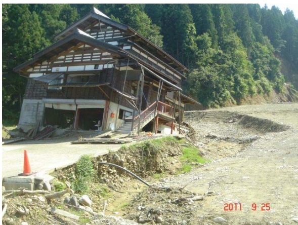
写真1 洪水による家屋被害
