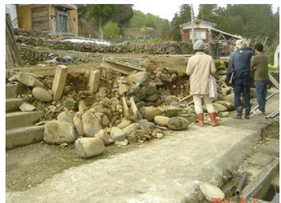
写真3 玉石擁壁の崩落(辰ノ口)
