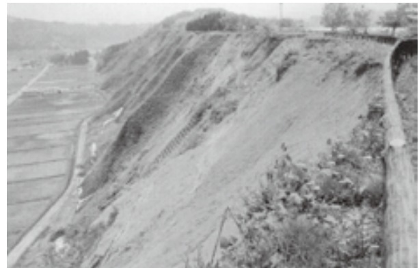
写真 1 段丘崖の肩で発生した崩壊例（越後川口 SA）
