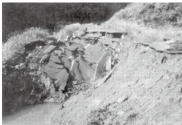
写真4 谷側に盛土して改良された部分の崩壊（長岡市法末）
