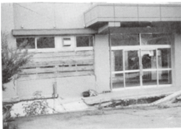
写真6 変状は切り盛り境界部に顕著に現れる (山古志中学校)。
