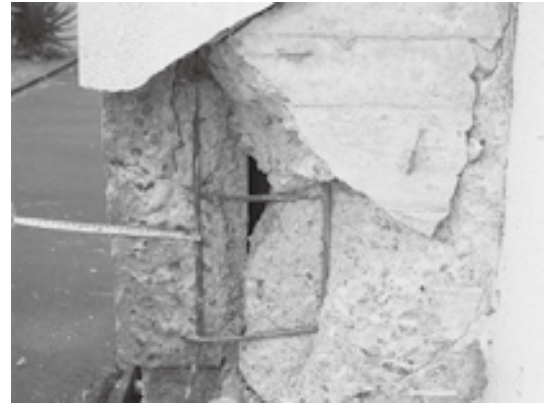
図9 越路中学校の被害
