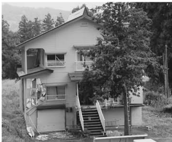
池谷における強震動による家屋の被害
