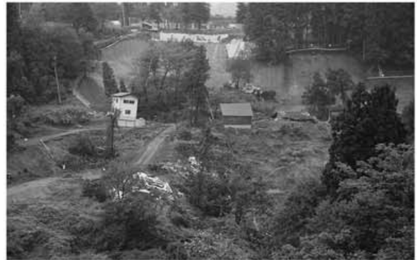
油夫の地すべり被害と復旧工事の様子
