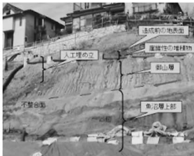
図2 高町団地北東部の崩落部の地質断面
