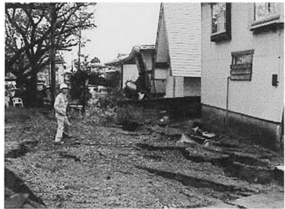
凹地を埋め立てた造成地では、液状化により基礎地盤が低い方に移動し建物や地面に多大な被害が発生した。家が並んでいる所は昔の谷筋にあたる。（長岡市・悠久山）
