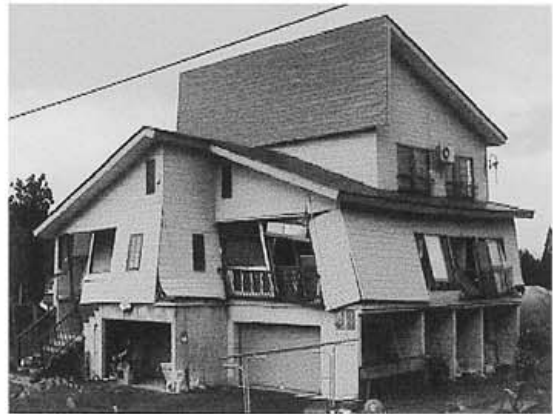
震源に近い所や特定な地域では、強い力により建物が押しつぶされた。下からの強い力により2階部分が押し潰された家（川口町・田麦山）
