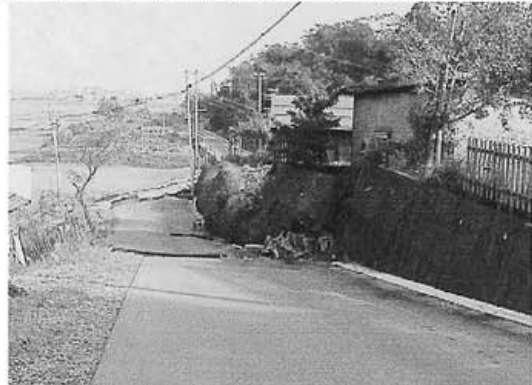
擁壁が振動や液状化により破損すると、建物の基礎地盤が移動し建物に変状をもたらす。写真のような立派な擁壁に限らず、住宅地にある小さな下水の壁が破損したり傾いても同じ様な被害が見られた。
