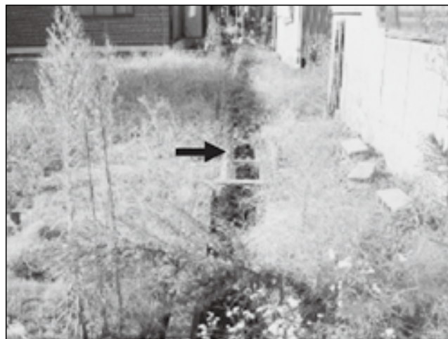
写真 3 側溝の変状と基礎地盤の側方移動
